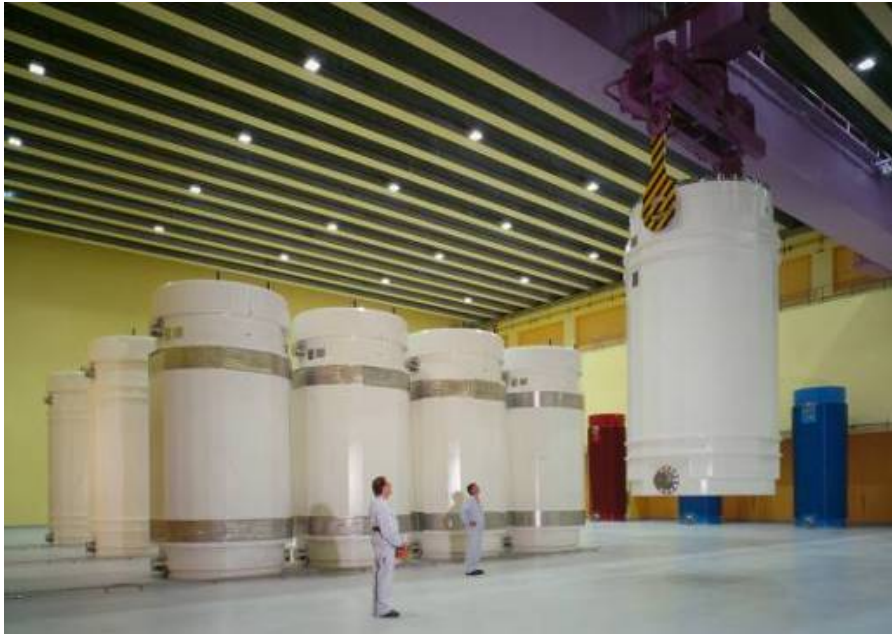
Behälter mit ausgedienten Brennelementen und hochradioaktiven Abfällen im Zwischenlager in Würenlingen. (Bild: Zwiilag)
