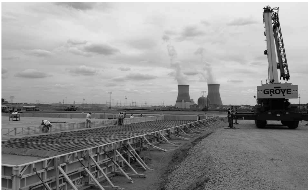
Les travaux préparatoires vont bon train sur le chantier des futures tranches nucléaires Vogtle 3 et 4.
