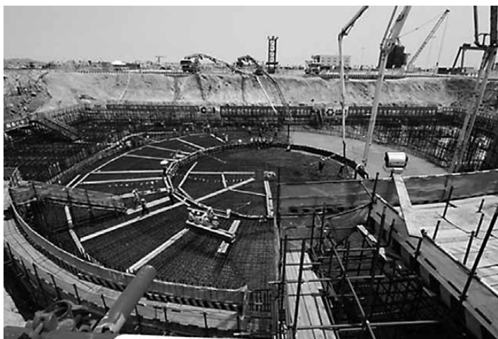
Les travaux de construction du quatrième AP-1000 ont officiellement commencé en juin à Haiyang.
