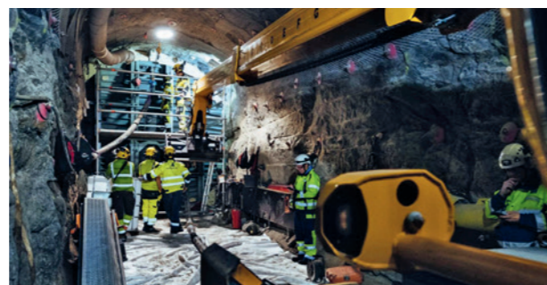
Une galerie du dépôt profond finlandais d'Onkalo. À compter de 2025, des assemblages combustibles usés seront stockés de manière durable et sûre à 400 mètres de profondeur. (Photo: Posiva)
