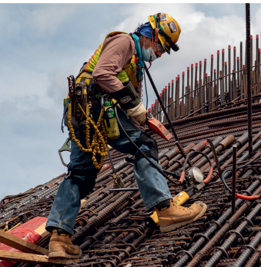
Le secteur nucléaire crée de nouveaux emplois. (Photo: Georgia Power Company)
