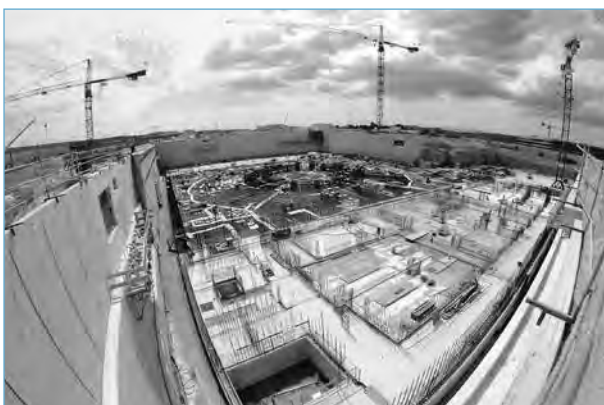
Am 26. Juni 2014 gossen Arbeiter im Süden der Iter-Tokamakgrube den Beton für die dritte und letzte Fundamentsektion des Tritiumgebäudes.
