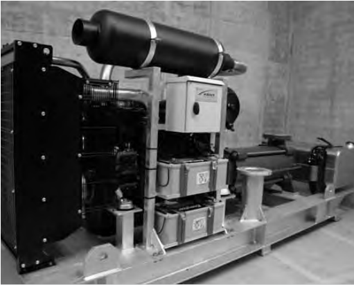
Grosse Wasserpumpe im Notfalllager Reitnau – bereit für den Transport per Hubschrauber dank eines speziell angefertigten Rahmens.
