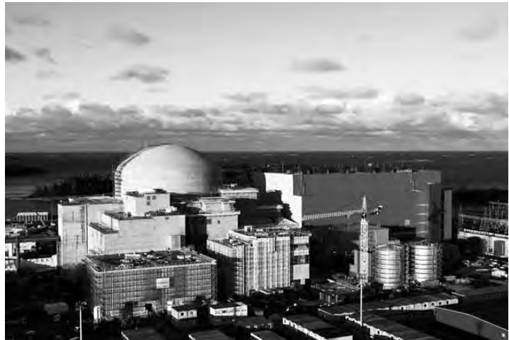
Der weltweit erste EPR, Olkiluoto-3 in Finnland, ist zu 80% fertiggestellt (Aufnahme vom 13. Oktober 2011).
